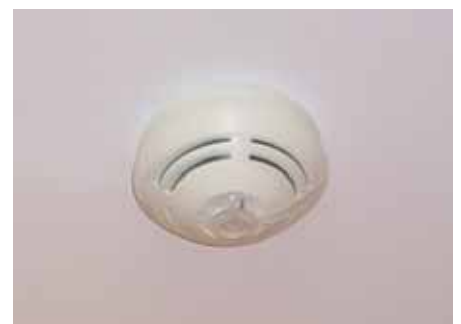
... sowie die IQ8Quad-Brandmelder behält.
